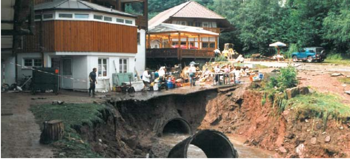
Hochwasserschäden am Tag nach dem Hochwasser (19.07.1999)
